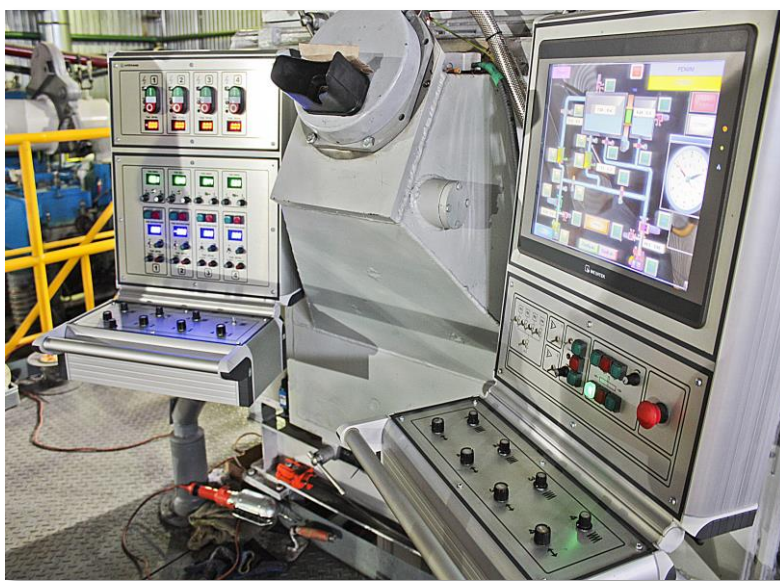
Рис. 6.27. Загальний вигляд пульта управління оператора установки
